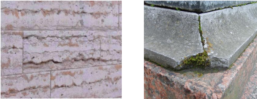
Fig. 6. Distrugerea pietrei de zidărie, exprimată prin prezența microfisurilor, microstraturilor și a substanțelor solubile și de înmuiere
