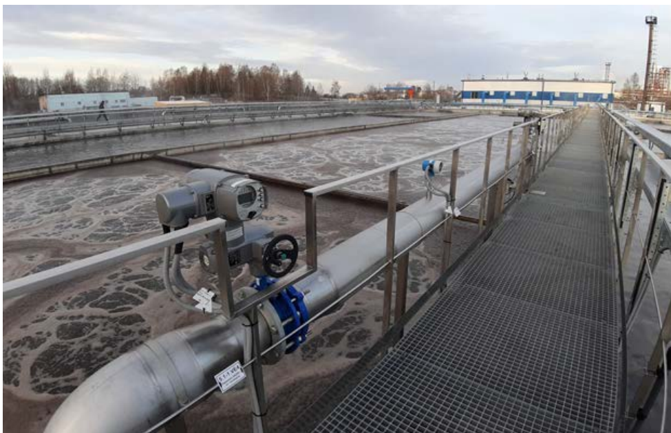
Рисунок 2. Аэротенки на очистных сооружениях г. Витебска
