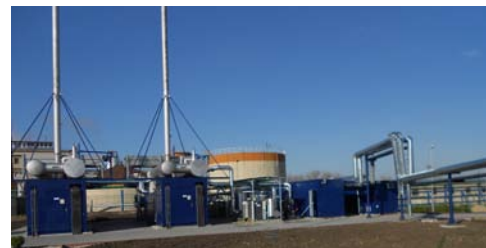
Figura 7. Generatoare stația de biogaz
