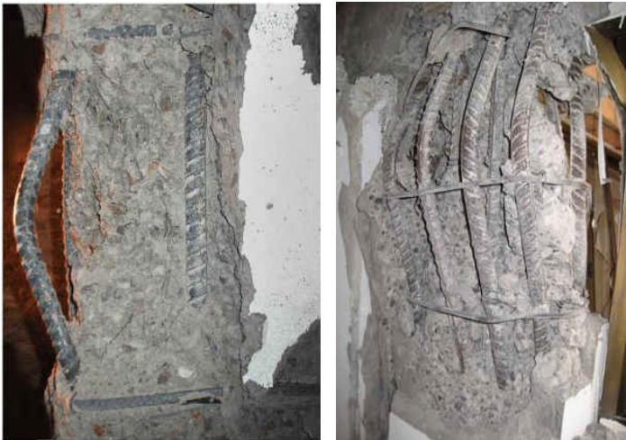
Figura 1.2.1. Pierderea stabilității armaturii din elementul de beton armat [5]
