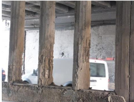
Figura 2. Pila pasajului Constanța înainte de executarea lucrărilor de reabilitare.
