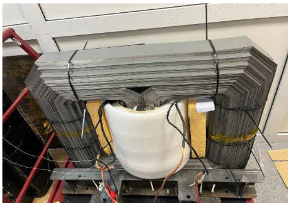
Рис. 2. Экспериментальная модель ВТСП трансформатора с функцией ограничения тока. 2
