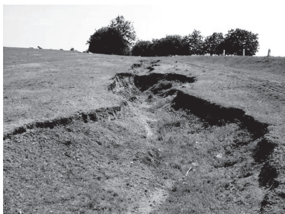
Efectele degradării pantelor
