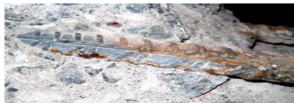
Figura 2. Coroziunea armăturii BST 500 în atmosfera industrială cu Cl 2 timp de 12 luni în zona fisurilor de mărime 0,2 - 0,5 mm la grosimea stratului de protecție din beton - 25 mm.
