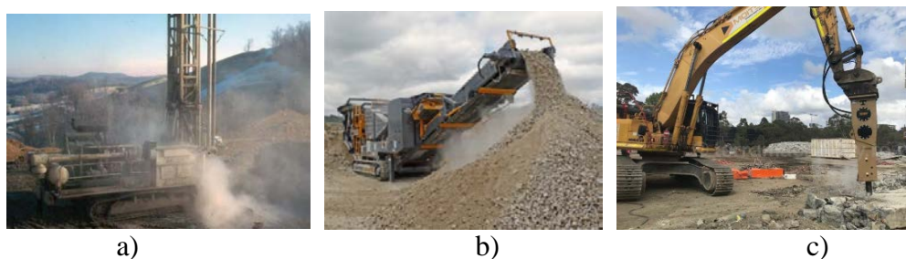
Fig. 1. Surse de poluare pe șantier [4]: a) echipament de forat; b) echipament de concasat; c) echipament pentru demolări.
