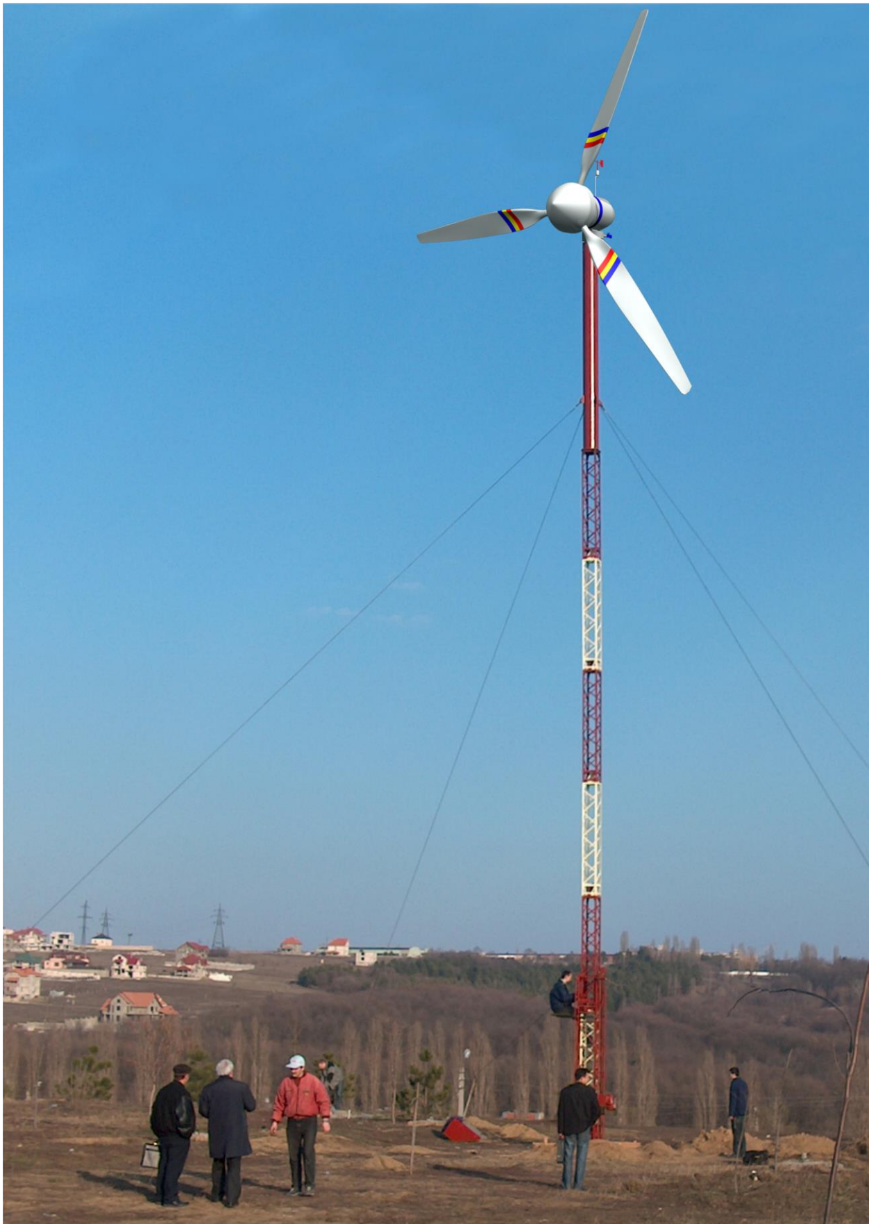
Fig. D.1. Vederea generală a turbinei eoliene cu puterea de 10 kW cu profil aerodinamic II al palelor (instalată în a. 2008 pe poligonul de testări a UTM).
