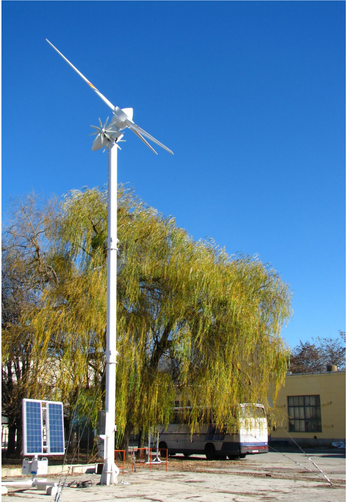
Fig. D.4. Vederea generală a turbinei eoliene (10 kW) cu rotor basculant orientat la direcția curenților de aer prin windrose cu profil aerodinamic al palelor (instalată pentru încercări experimentale pe poligonul UTM, CITM “Etalon”, UTM, a. 2013).
