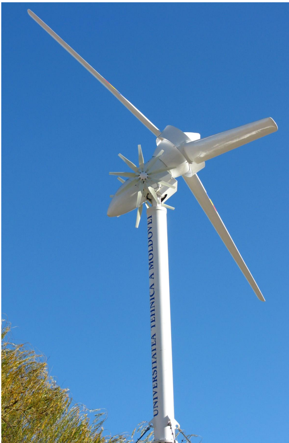
Fig. D.11. Vederea generală a turbinei eoliene (10 kW) cu rotor basculant orientat la direcția curenților de aer prin windrose cu profil aerodinamic al paletelor (instalată în Parcul-Muzeu al Tehnicii, campusul Râșcani, UTM, a. 2013).
