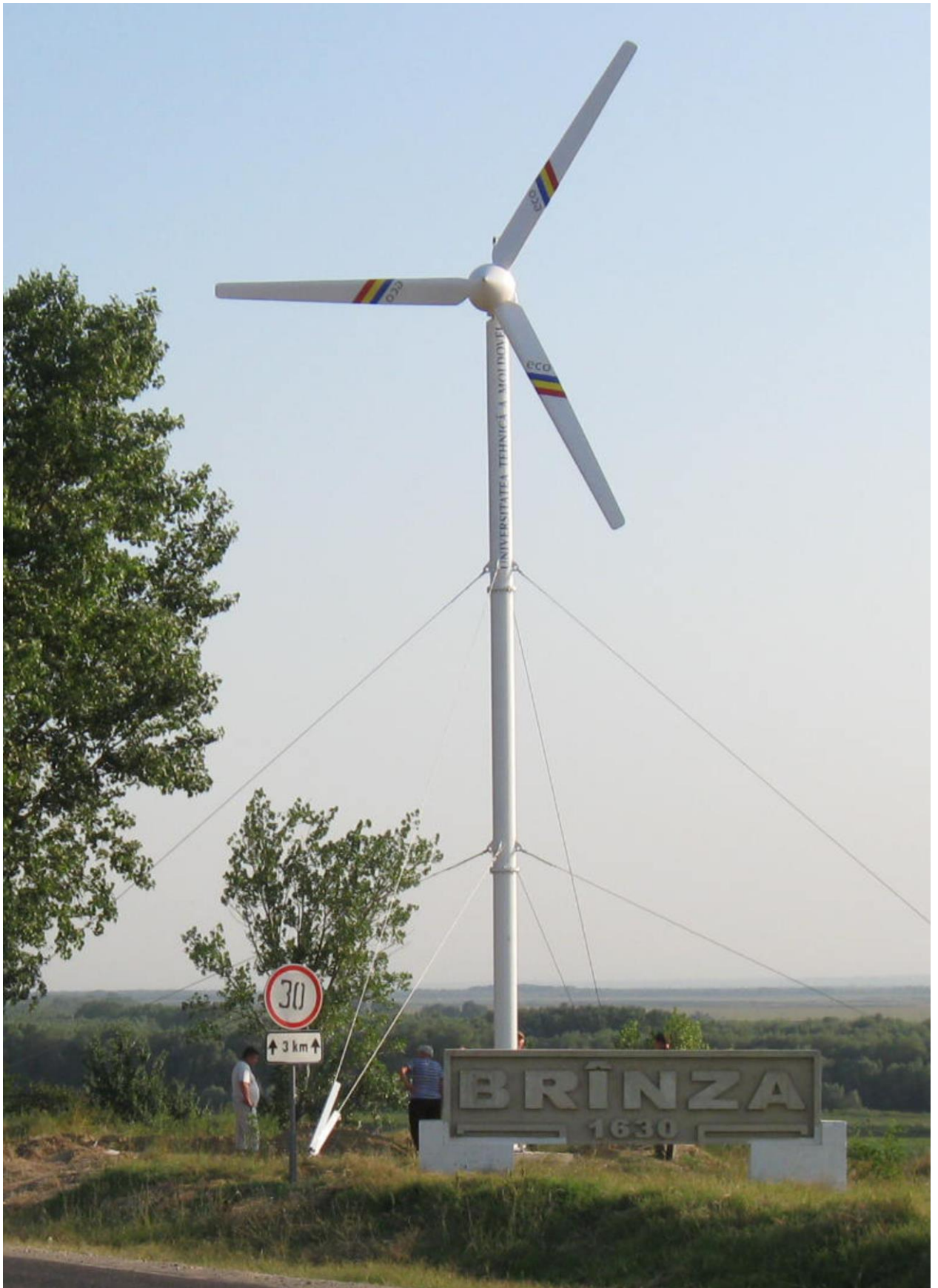
Fig. D.6. Vederea generală a turbinei eoliene cu puterea de 10 kW pentru alimentarea cu energie electrică a pompei pentru pomparea apei din fântâna arteziană în apeductul comunei Brînza (H=165 m).
