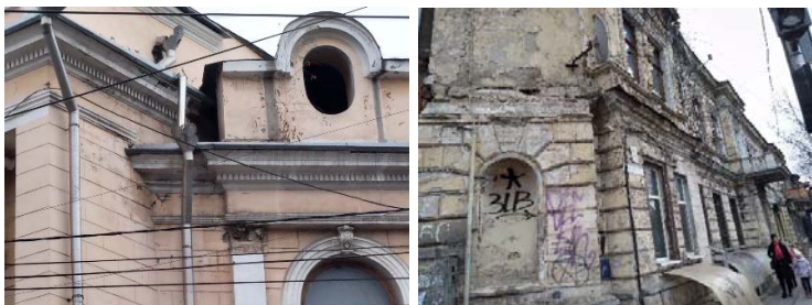
Fig.3.29. Starea fațadelor clădirilor monumente arhitecturale amplasate pe str.București, cca 10 ani după reparație
