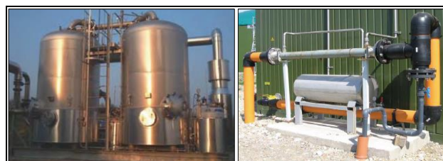
Figura 5. Instalația de purificare a biogazului și cea de uscare
