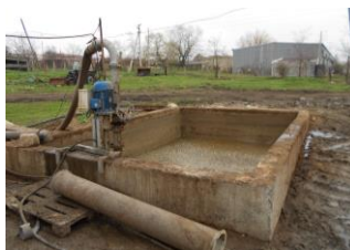
Fig. A2.2. Rezervorul de stocare a materiei prime
