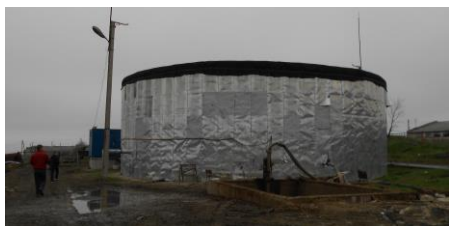
Figura A2.1. Vedere a stației de biogaz
