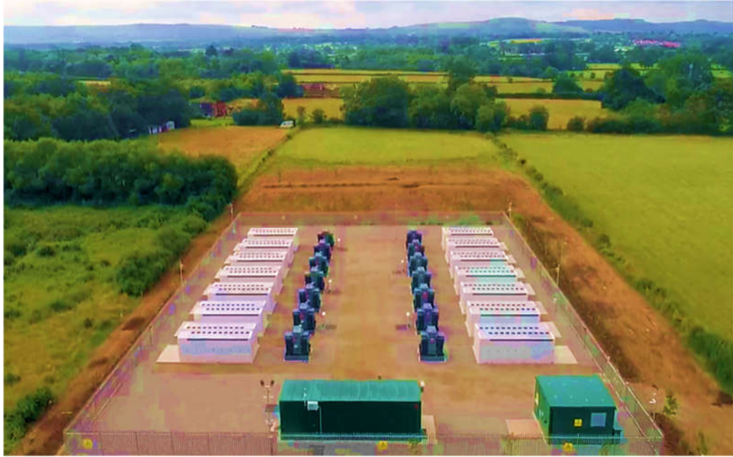
Figura A1.8. Baterie de 68 MWh din Marea Britanie ce urmeaza să fie inclusă în portofoliul Autobidder
