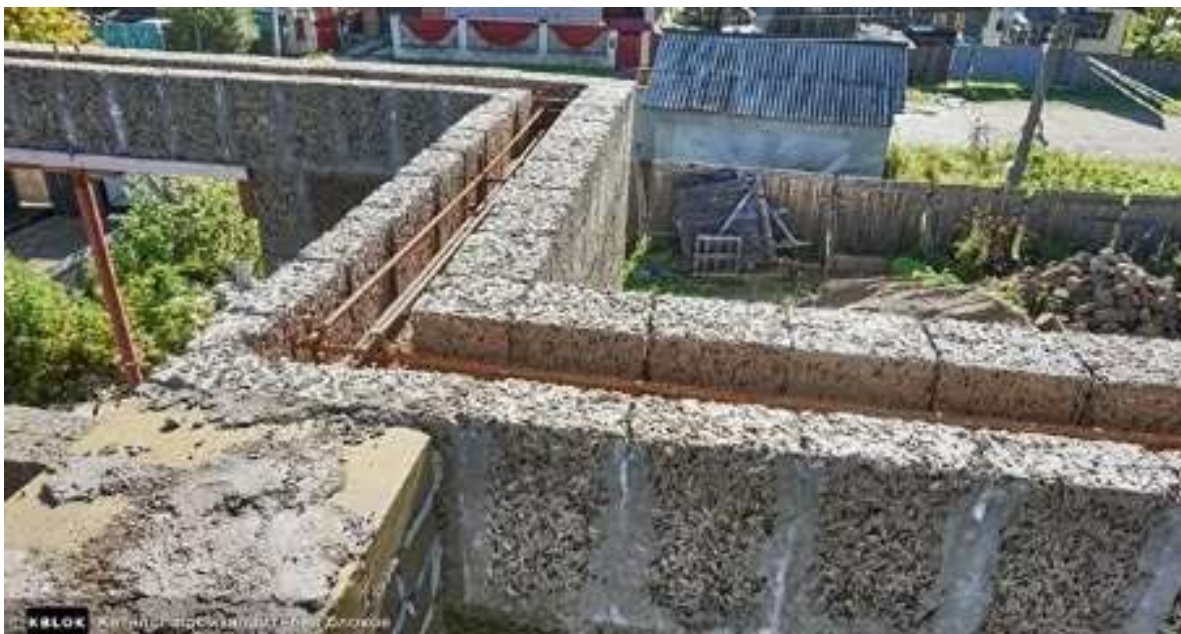
Figura 3. Executarea pereților unei case și turnarea centurei din beton armat pe contur [6]
