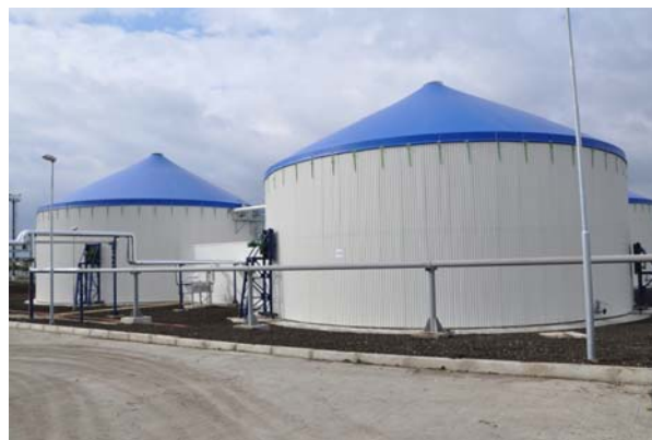
Figura 5. Stație de biogas din mun. Drochia sunt puse în exploatare doua stații de producere a biogazului, una e pusă pe bază unei gospodări
