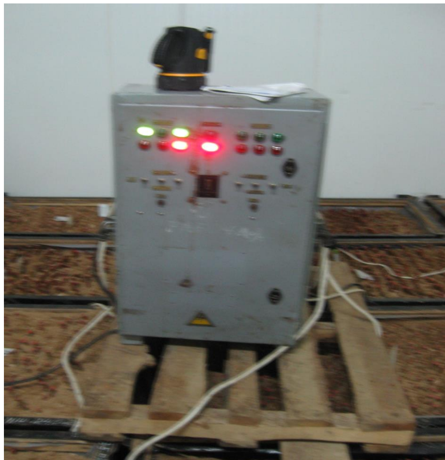
Figura 4. Instalație cu set complet de containere
