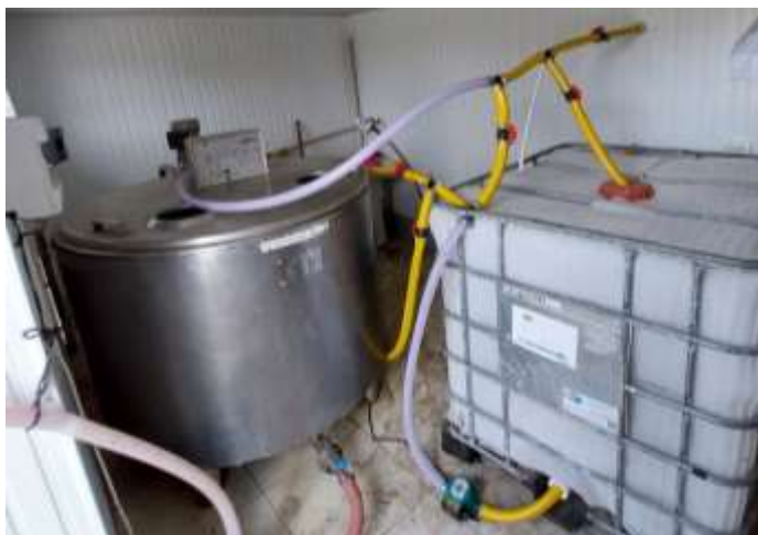
Fig. 4.2. Partea interioară a instalației ecologice experimentale cu consum redus de energie electrică
