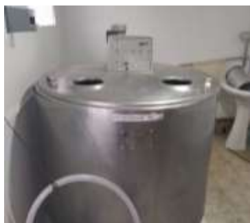
Fig. 1.1. Instalația frigorifică a punctului de colectare a laptelui din satul Corbu, r-nul. Donușeni
