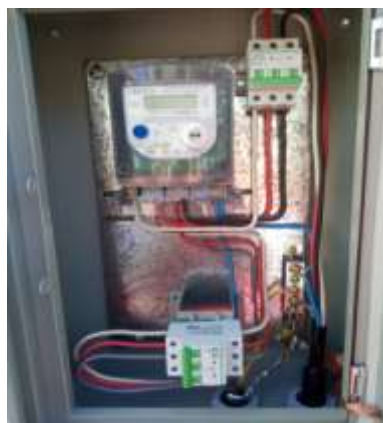
Fig. 4.10 Panou de evidență cu contorizare netă
