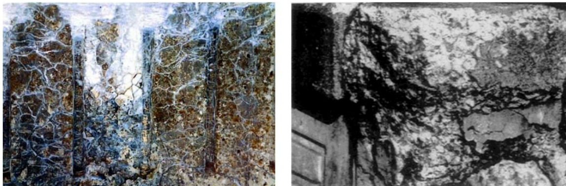
Figura 3. Element de beton în urma ciclurilor de îngheț-dezgheț [7]
