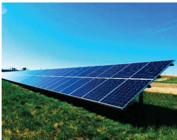
Fig. 6.3. Panouri fotovoltaice instalate la so
