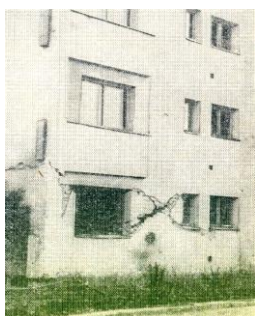
Рис. 1.12. Повреждение стен с слабым сцеплением между кирпичем и раствором в здании с АС поясами, во время землетрясения в Румынии, в 1977 г. [94, с. 189].
