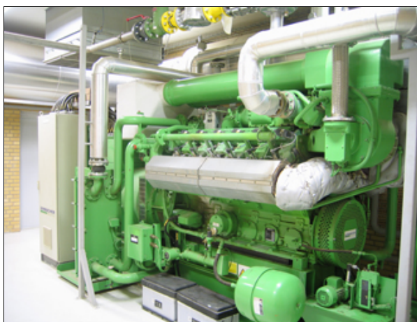
Figura 3. Instalație de cogenerare MAI, pe biogaz [8].
