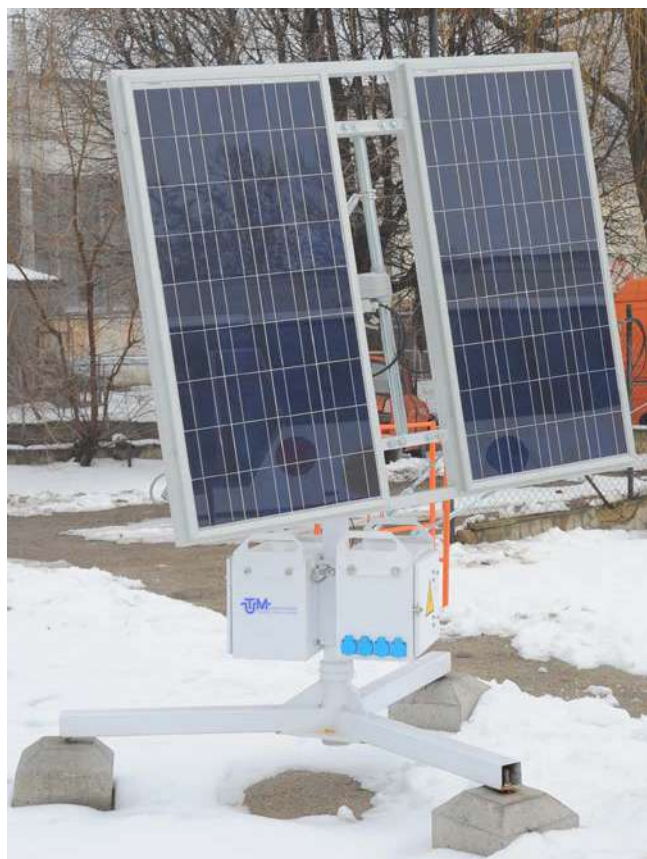
Figura 7.3 (b) Instalații fotovoltaice elaborate cu puterea 375W
