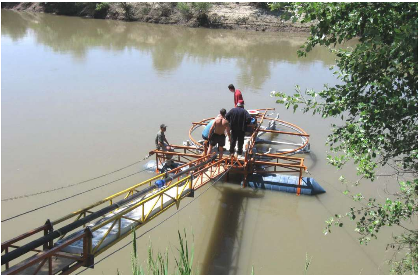
Testarea microhidrocentralei de flux pe râul Prut, (com. Stoienești, Cahul, 2011). Figura 7.2 (c) Microhidrocentrala de flux cu rotor hidrodinamic basculant cu 5 pale cu lungimea cordului l=800\text{mm} și ecrane pentru direcționarea curgerii fluidului și testarea microhidrocentralei de flux pe râul Prut, (com. Stoienești, Cahul, 2011).
