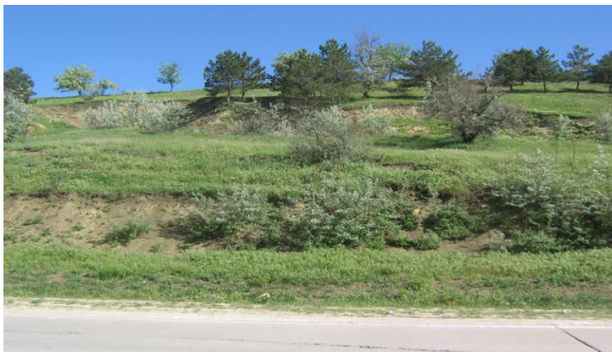
Рис. П.2. Разрушение откоса выемки на участке автодороги Кишинэу-Бэлць
