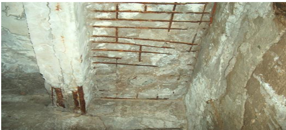
Рис.4. Быстрому разрушению бетонных конструкций способствуют мелкие трещины, через которые внутрь поступает влага.
