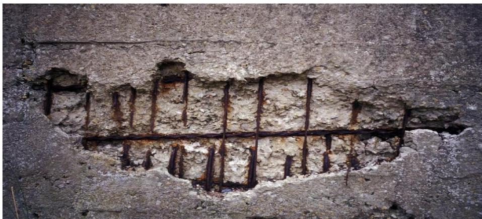
Рис.2. Наиболее подвержены коррозии цементные швы. Это связано с тем, что они – наименее прочное звено в конструкции.
