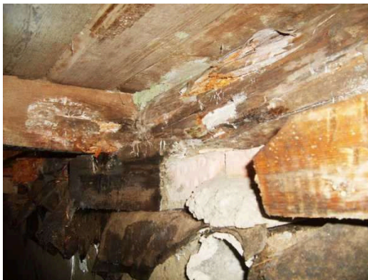
Figura3. Nodul deteriorat din cauza putrezirii [2]
