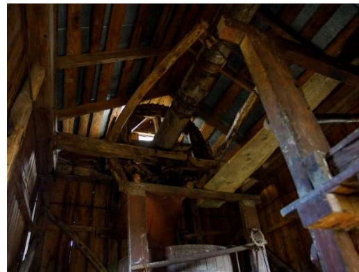
Figura4. Interiorul moarei, fiind vizibile încovoierile elementelor portante [2]
