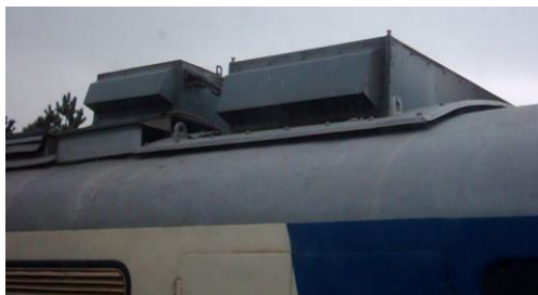
Fig.4 Amplasare convertor static tip INDA pe locomotiva diesel-electrica 060 DA (DA1)
