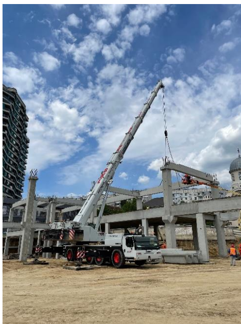
Figura 6. Construirea centrului comercial KAUF LAND din elemente prefabricate din beton armat or. Chișinău
