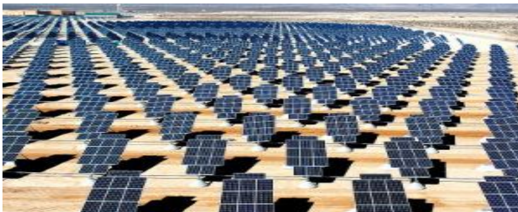
Fig. 2 Complex de energie solară
